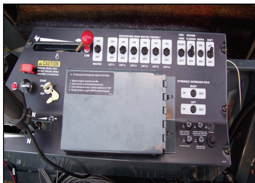
Interruptor do seletor do tanque de combustível (Localizado no console lateral) -Vista típica
