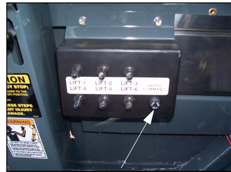
Osigurač za komandu dubine (smešten na panelu sa prekidačima za dizalice) - Uobičajeni izgled
