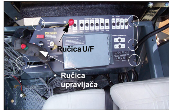
Automatski osigurači (smešteni na bočnoj konzoli) - Uobičajeni izgled
