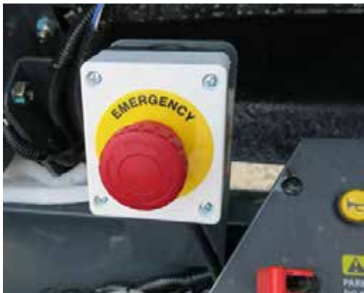
Кнопка аварийного останова (расположена возле боковой панели) – стандартный вид
