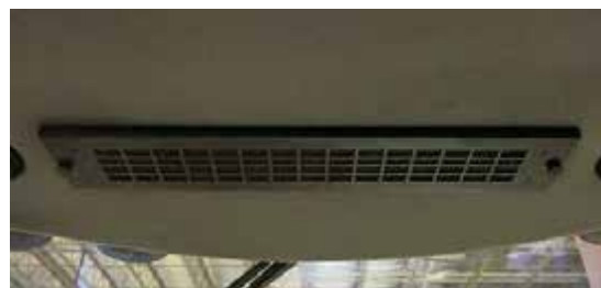
驾驶室新风过滤器入口 （位于驾驶室顶衬上） - 典型视图
