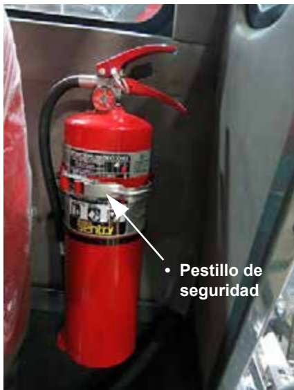
Extintor de incendios (ubicado junto al asiento del operador) -Vista típica
