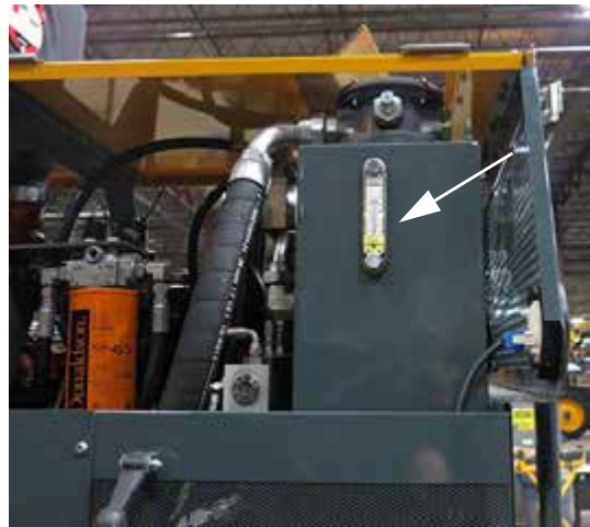
Indicador visual del nivel del depósito de aceite (ubicado en la parte delantera del depósito de aceite hidráulico) - Vista típica
