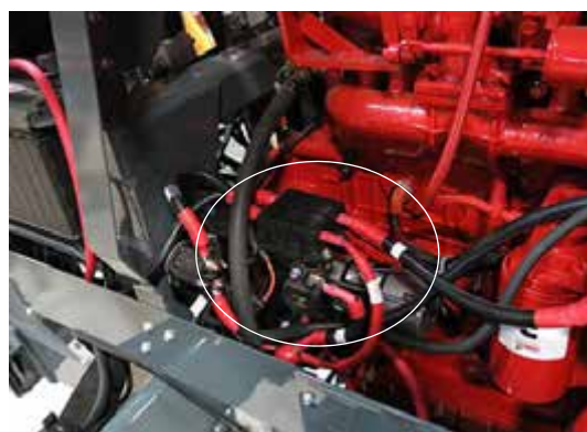
Fusibles e interruptor automático del arnés de cableado (ubicados en el lado derecho del motor) - Vista típica
