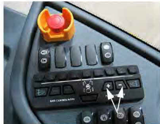
Interruptores de velocidad/tasa de la bomba (ubicados en la consola lateral)
