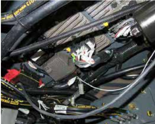
Interruptores automáticos/fusibles (exteriores) (ubicados debajo de la cabina; quite el panel para tener acceso) - Vista típica
