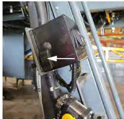
Interruptor de aspersión nocturna (ubicado en el lateral de la caja de interruptores cerca de la escalera) -Vista típica
