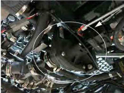
Bomba de solución (ubicada debajo del centro de la máquina) -Vista típica
