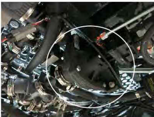
Bomba de solución (ubicada debajo del centro de la máquina) -Vista típica
