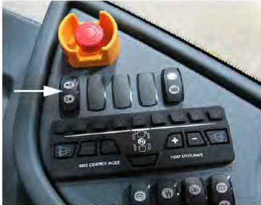
Interruptor del marcador de espuma (ubicado en la consola lateral) -Vista típica
