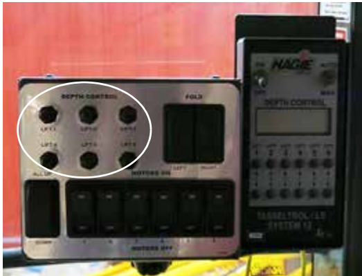
Interruptores de control de profundidad (ubicados en el panel de control de despenchado) -Vista típica
