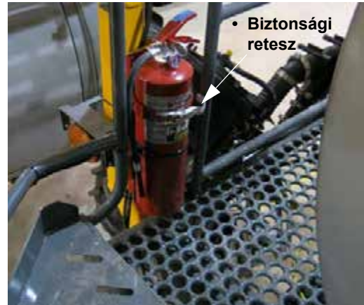
Tűzoltókészülék (a gép bal-kéz felőli oldalán lévő járópalló mentén) – Tipikus nézet
