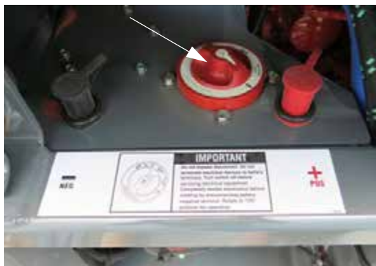
Comutator de deconectare a bateriei (amplasate pe cadrul principal din spate) - Vedere tipică
