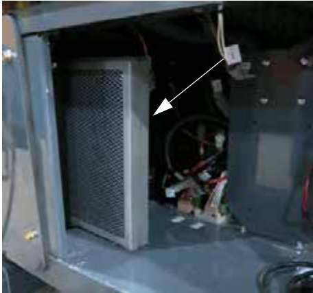
Filtru cu cărbune - Vedere tipică
