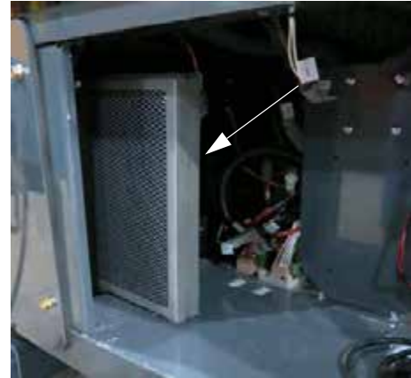
Filtru cu cărbune - Vedere tipică
