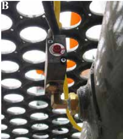
Supapa pilot (amplasată lângă rezervorul de aer) - Vedere tipică
