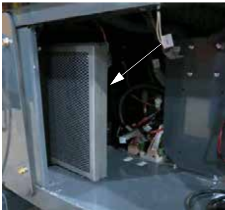
Filtru cu cărbune - Vedere tipică
