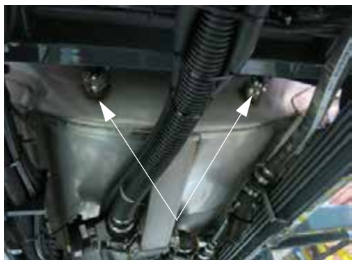
Agitatoare de jet (Două amplasate pe fiecare capăt al rezervorului de soluție) - Vedere tipică
