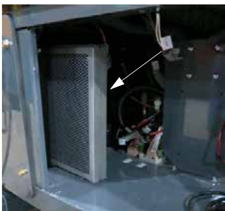
Filtru cu cărbune - Vedere tipică
