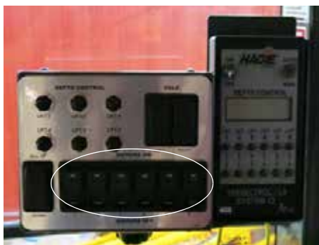
Выключатели цепи управления электроприводом (расположены на Пульте управления удалением метелок кукурузы) - стандартный вид
