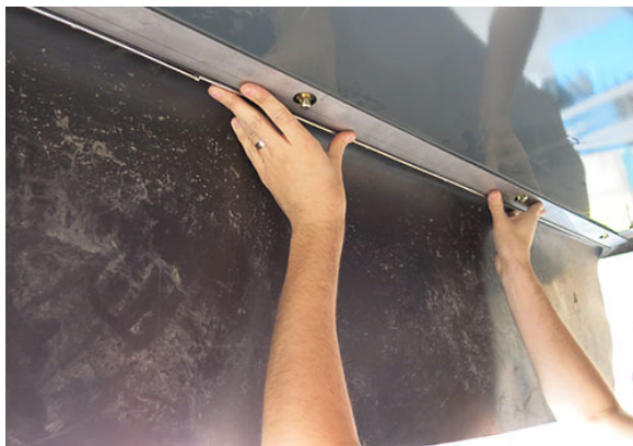
Súrolásvédelmi gumifüggöny telepítés – Tipikus nézet
