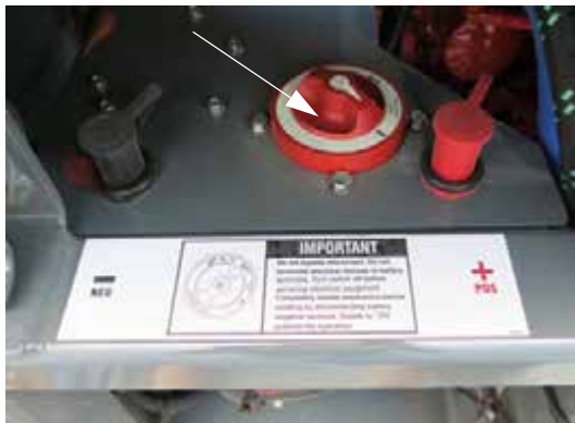
Akkumulátor megszakító kapcsolója (a hátsó alvázkereten) – Tipikus nézet
