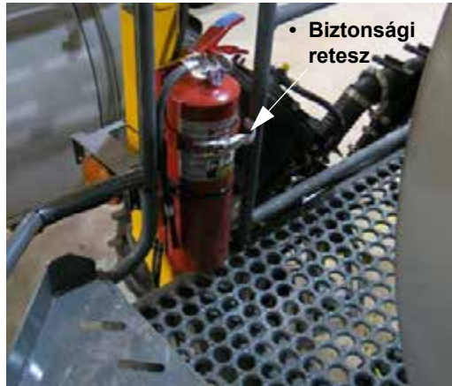
Tűzoltókészülék (a gép bal-kéz felőli oldalán lévő járópalló mentén) – Tipikus nézet
