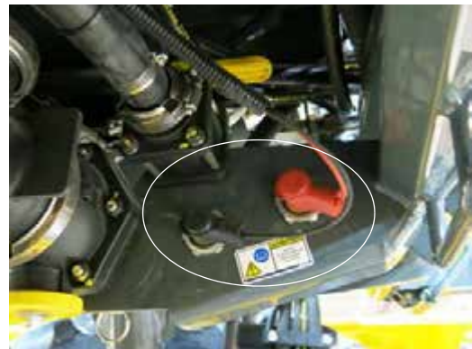
Táp csatlakozások (elülső töltő összeszerelés közelében van) – Tipikus nézet
