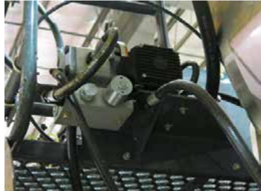
Nagynyomású tisztító szivattyú (a gép jobb oldalán hátul) – Tipikus nézet
