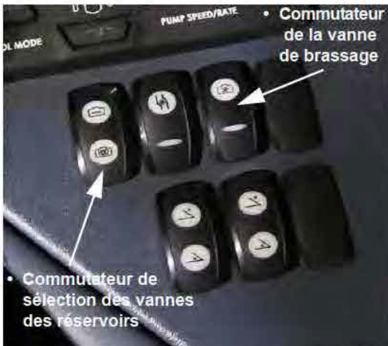
Commutateurs de sélection des vannes des réservoirs et de la vanne de brassage (situés sur la console latérale) - Vue typique
