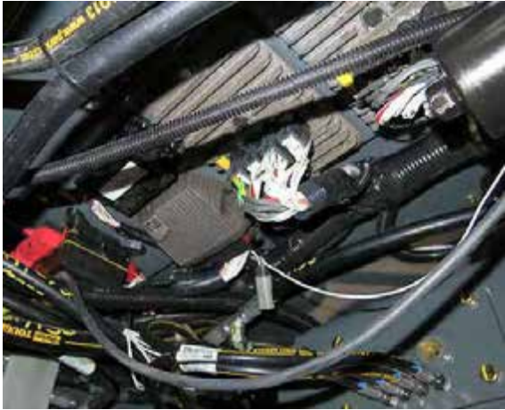
Disjoncteurs / fusibles (extérieurs) (situés en dessous de la cabine - retirez le panneau pour y accéder) - Vue typique
