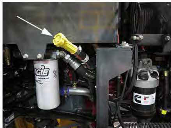
Orifice de remplissage d'huile moteur à distance (situé à l'arrière gauche de la machine - ouvrez le capot pour y accéder) - Vue typique
