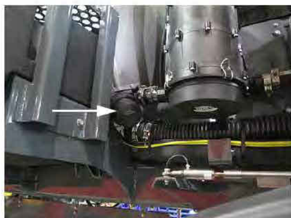
Crépine en ligne de la solution - Secondaire (situé près de l'avant droit de la machine) - Vue typique
