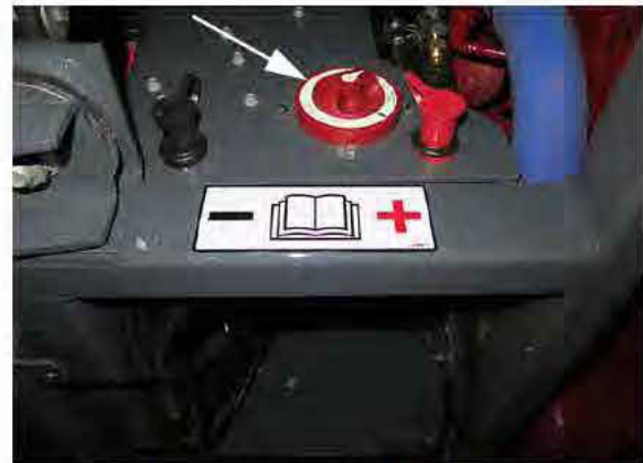
Sectionneur général de la batterie (situé sur le châssis principal arrière) - Vue typique
