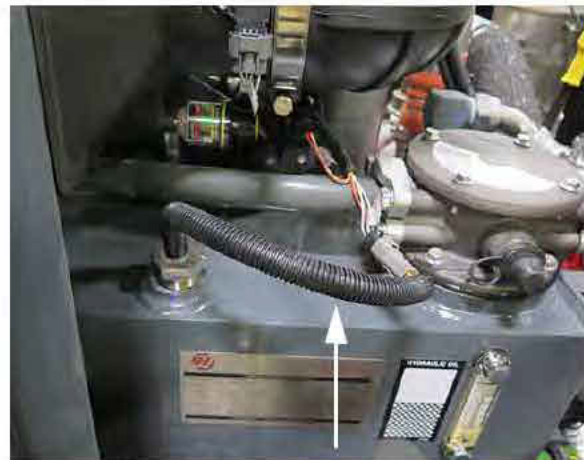
Capteur de niveau / température (situé sur le dessus du réservoir d'huile hydraulique) - Vue typique
