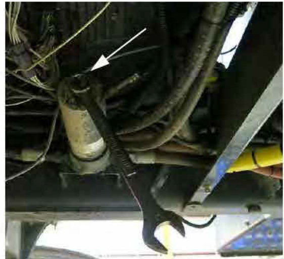
Boîtier du filtre sous pression (situé sous le côté droit de la cabine - ouvrez le capot pour y accéder) - Vue typique
