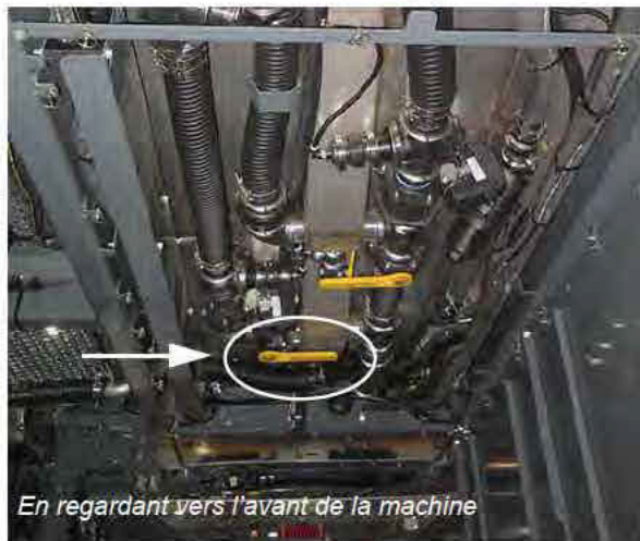
Vanne d'arrêt manuelle du réservoir 1 (située sous la partie centrale de la machine) - Vue typique
