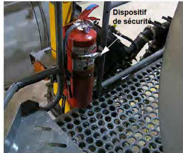
Extincteur d'incendie (situé le long de la plate-forme sur le côté gauche de la machine) - Vue typique
