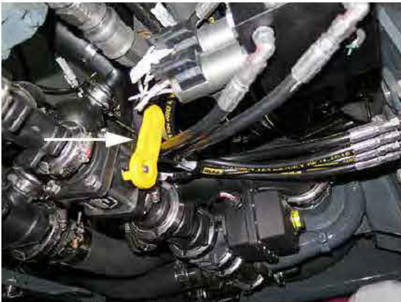
Vanne d'arrêt du brassage (située sous la partie arrière de la machine) - Vue typique
