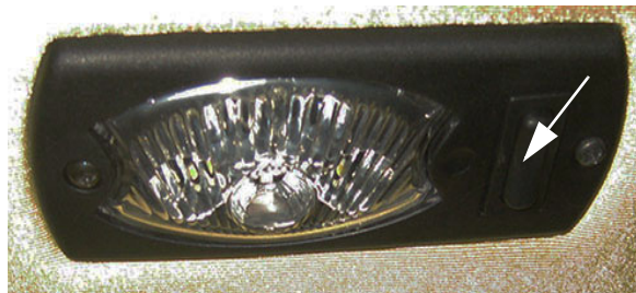
Belső munkalámpa kapcsoló – Tipikus nézet
