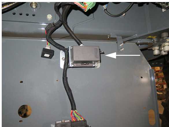
Permetlé szivattyú relé tartódoboz (A fülke elülső vége alatt helyezkedik el - hozzáférés az alsó panelen keresztül) – Tipikus nézet
