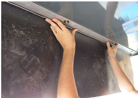
Súrolásvédelmi gumifüggöny telepítés – Tipikus nézet
