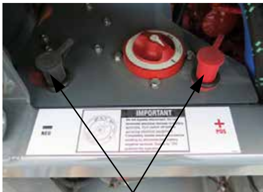
Kiegészítő akkumulátor töltő csatlakozó (a hátsó alvázkereten) – Tipikus nézet
